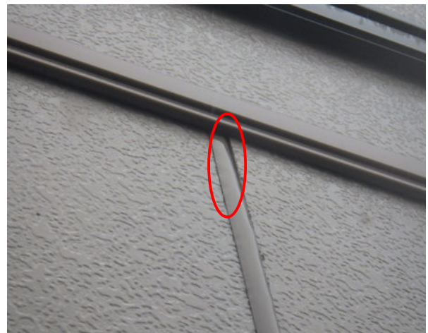
【外周り】 劣化等の箇所 4 外壁目地のガスケットと外壁板にずれが生じている箇所がありました。雨水の浸入の要因となりますので、外壁塗装メンテナンスの際に合わせてガスケットのメンテナンスをお勧めします。
