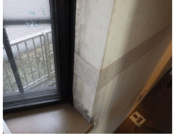
【室内】 劣化等の箇所 2
