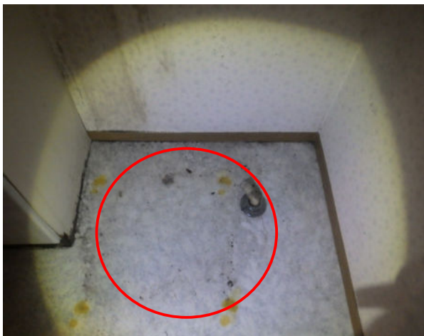
【室内】 劣化等の箇所 3
