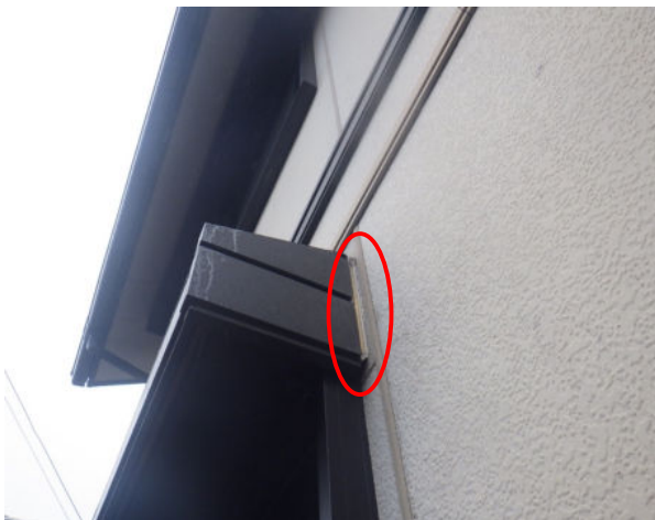
【外周り】 劣化等の箇所 3 シャッターボックス脇のシーリングがほぼ劣化してなくなっている箇所がありました。日当たりの良い箇所はほぼ全てこの状態です。雨水の浸入の要因となりますので、外壁塗装メンテナンスの際に合わせてシーリングのメンテナンスをお勧めします。
