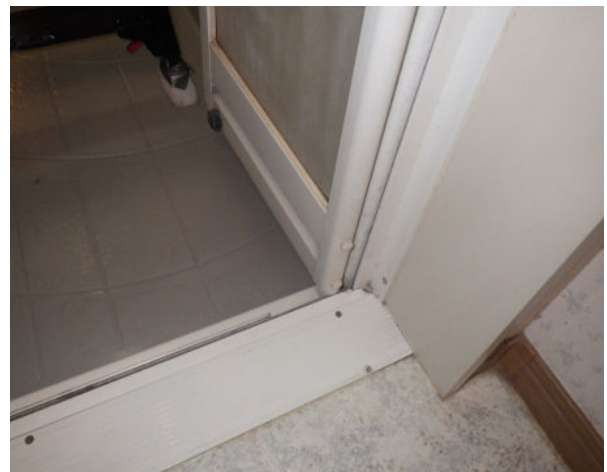
【室内】 劣化等の箇所 4
