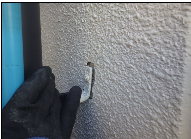
【外周り】 指摘箇所 3 縦樋固定金物と外壁の固定が不十分で、縦樋にぐらつきがありました。上部も同様の状態の箇所がありますので、補修等をお勧めします。
