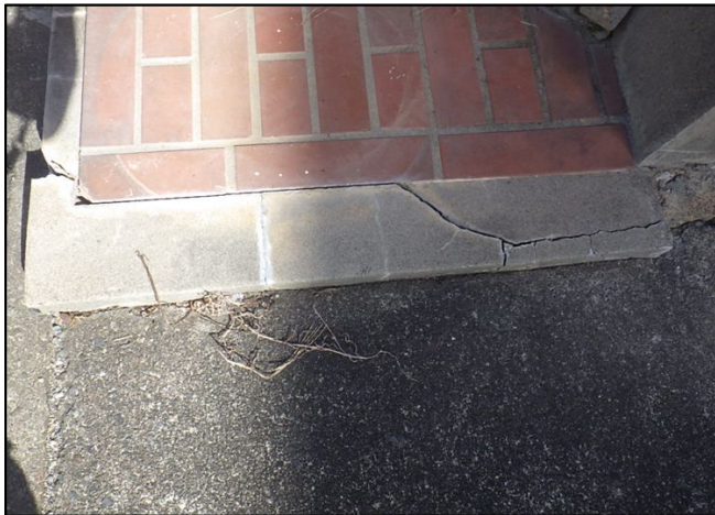
【外周り】 指摘箇所 1 アプローチ部分の縁石にひび割れが見られました。 外観を気にされるようでしたら、補修等を行うとよいでしょう。
