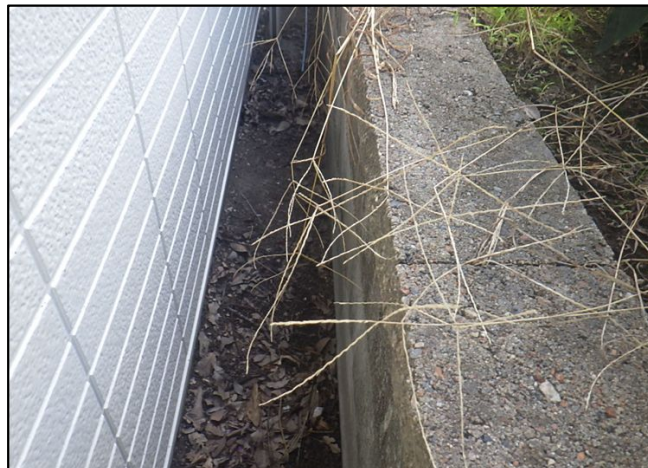
【外周り】 指摘箇所 2 道路側花壇背面と建物の間にデッドスペースとなる隙間があります。外部から落ち葉などのゴミが溜まってしまいうスペースとなっていましたので、上部を塞ぐなどの対策をおすすめします。
